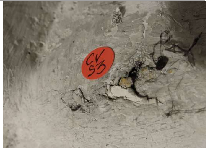
Ci-dessus: CV S3 , sur la jonction clé/arc, enduit raccord, soulevé, laissant apparaître une couche d'ocre jaune et des traces de rouge.
