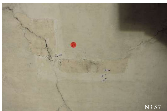
Ci-dessus: N3 S7, le long d'une fissure R (?) réparation fissure, plâtre et fibres e2 enduit du XVIIIe s.
